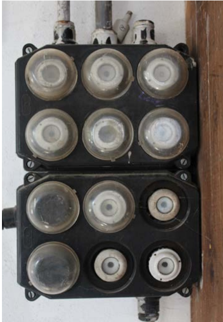
um 1920 hochmodern – die Elektrik in der Schreinerei aus Ohmenhausen
